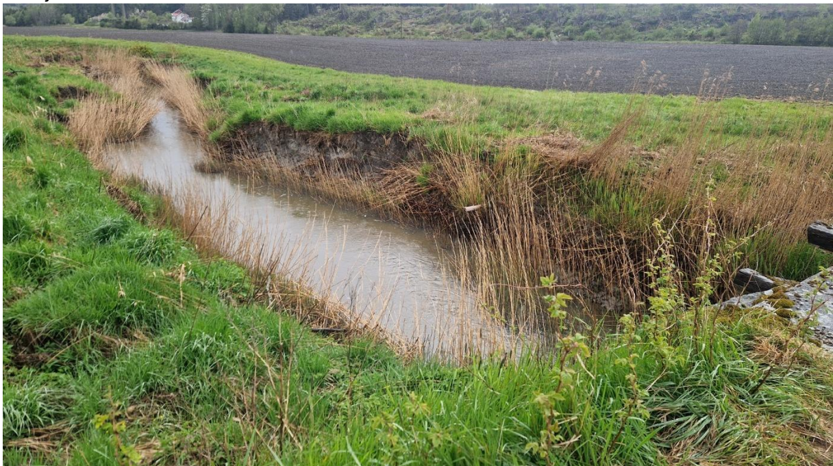
Erosjon og manglende kantvegetasjon
