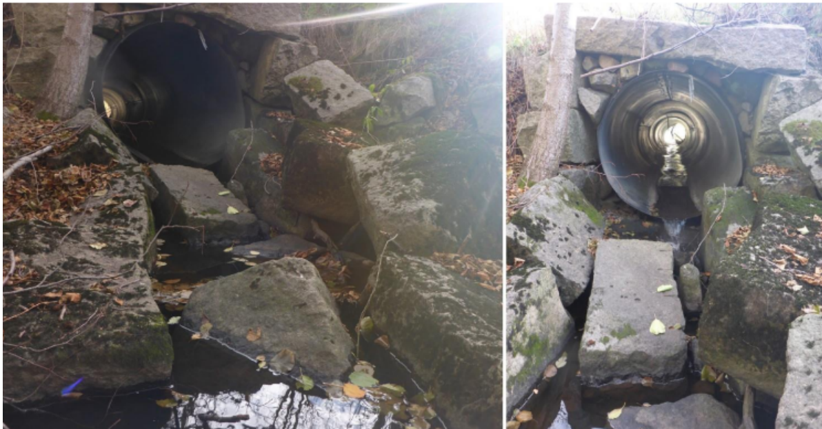
Figur 3 Utløp av kulvert, utglidning av steinblokker
