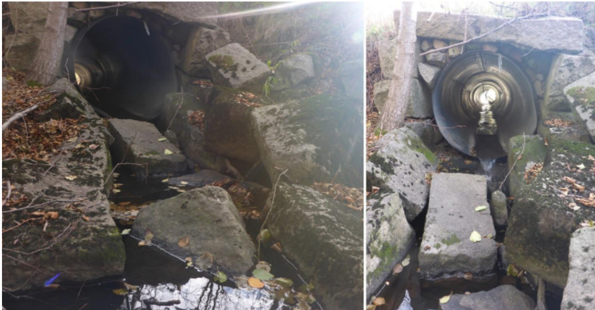
Figur 5 Utløp av kulvert, utglidning av steinblokker
