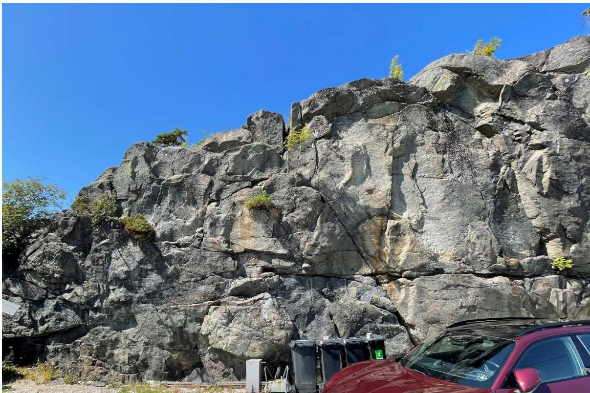
Figur 7. Oppsprukket berg langs eiendommen til en av grunneierne i området.
